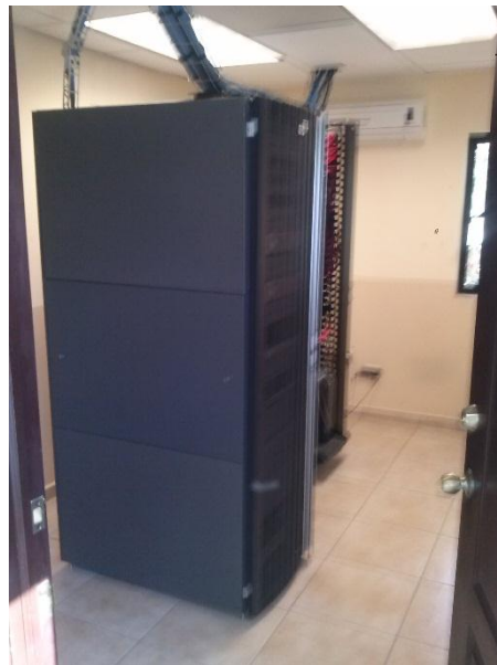
Figura 7. En esta imagen podemos observar la instalación de redes y el servidor de la de base de datos que se encuentran aislado del personal y sólo puede entrar personal capacitado.
