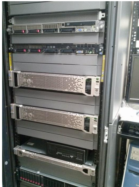
Figura 5. En esta imagen podemos observar el servidor de base de datos al que se le aplicó mantenimiento preventivo.
