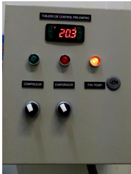
Figura 7. Tablero de control de temperatura del área de Proceso Food Service.
