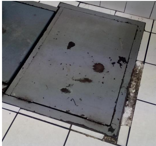
Figura 12: Daño de Grieta en Anteprocreso.
