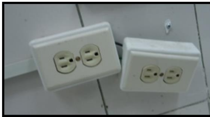
Figura 17: Contacto Eléctrico Dañado
