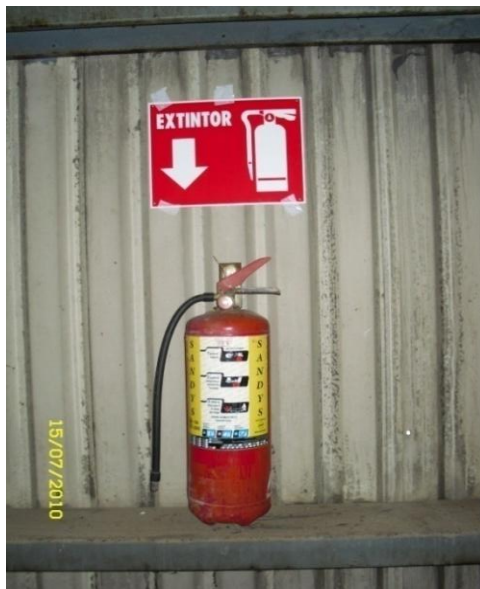
Figura 19. Área con extintor
