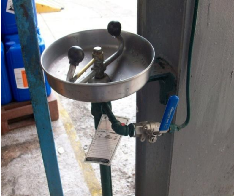
Figura 13. Lavaojos con maneral adecuado de libre acceso.
