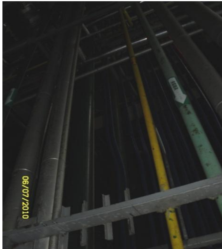
Figura 15. Tuberia sin etiquetas de direccion de flujo
