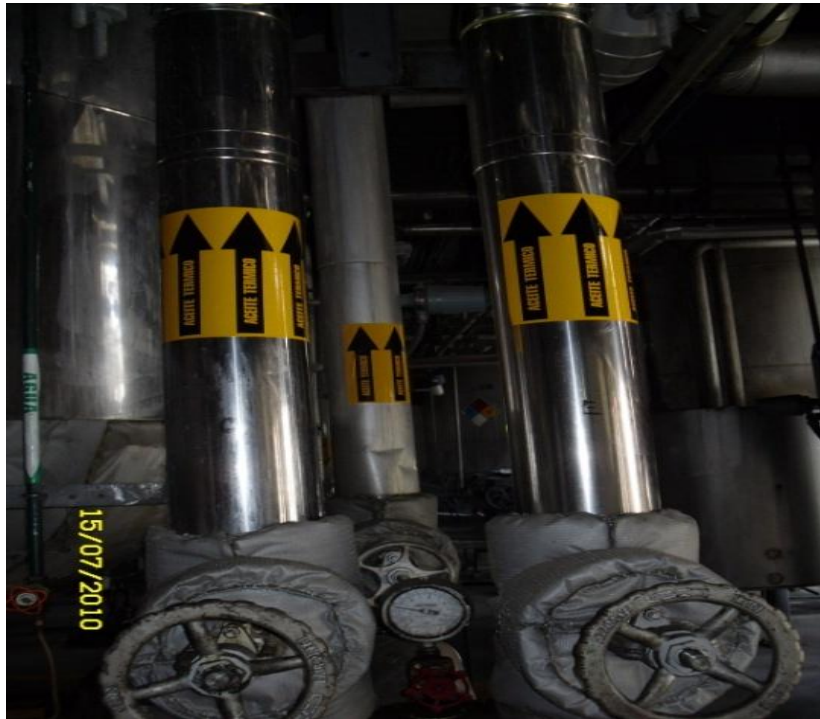
Figura 16. Tuberia con etiquetas de direccion de flujo
