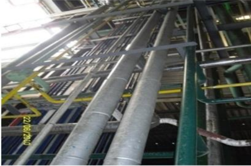
Figura 14. Tuberia sin etiquetas de direccion de flujo
