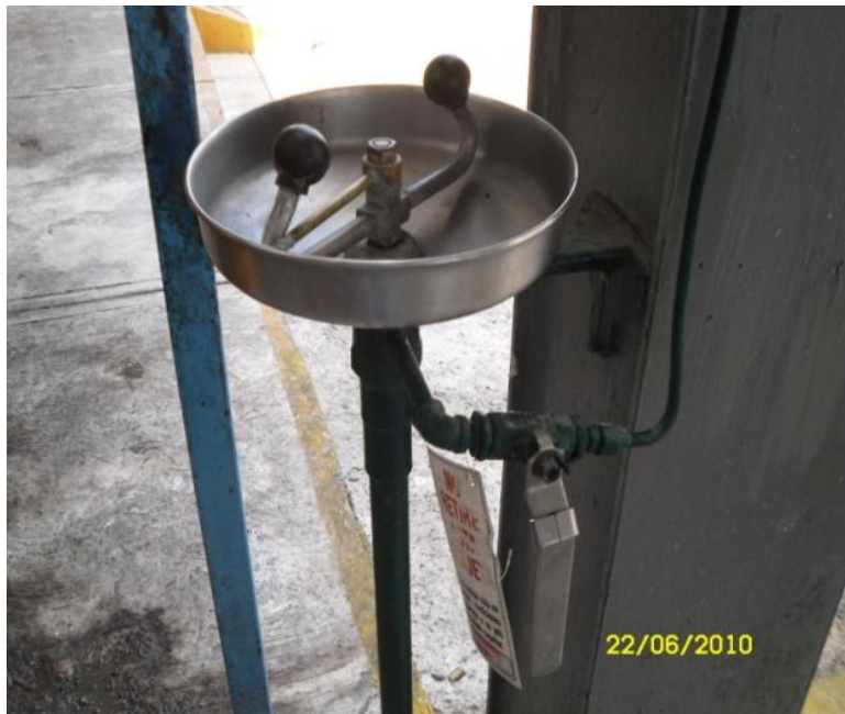
Figura 12. Lavaojos con maneral inadecuado
