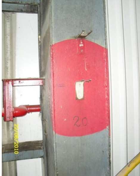
Figura 18. Área sin extintor
