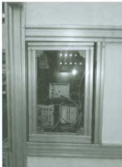
Figura 5.41 Caja de controles
