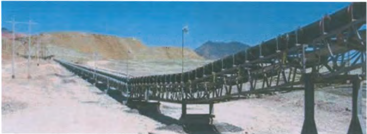
Figura 14. Banda transportadora de quebalix I.
