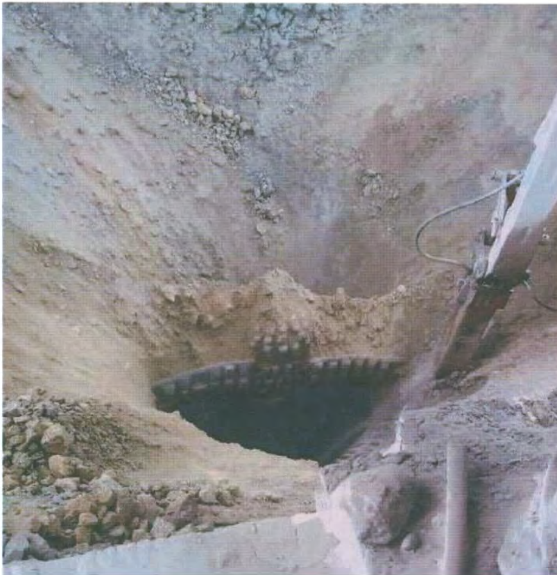
Figura 13. Entrada de alimentación de quebradora de cono.
