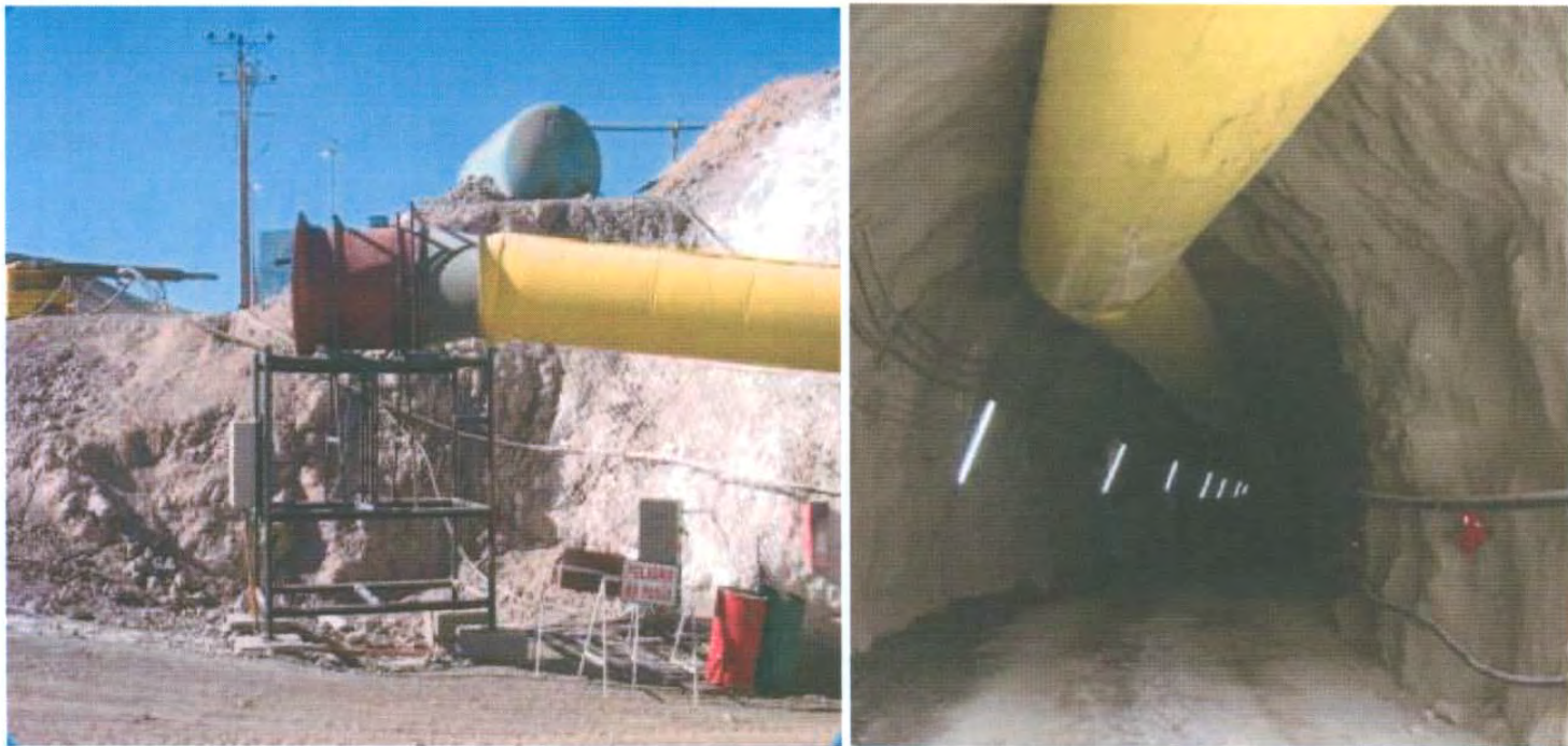
Figura 10. Mangas de ventilación.
