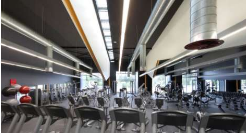
Fotografía 11. Detalle de las instalaciones de refrigeración aparentes.
