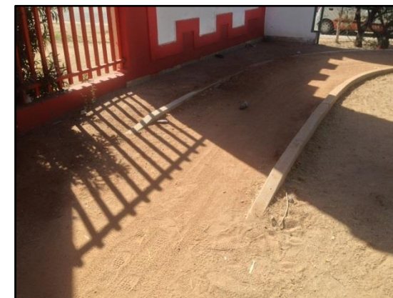
Imagen 23. Fotografía de trotapista sin continuidad. Fuente: Archivo propio.
