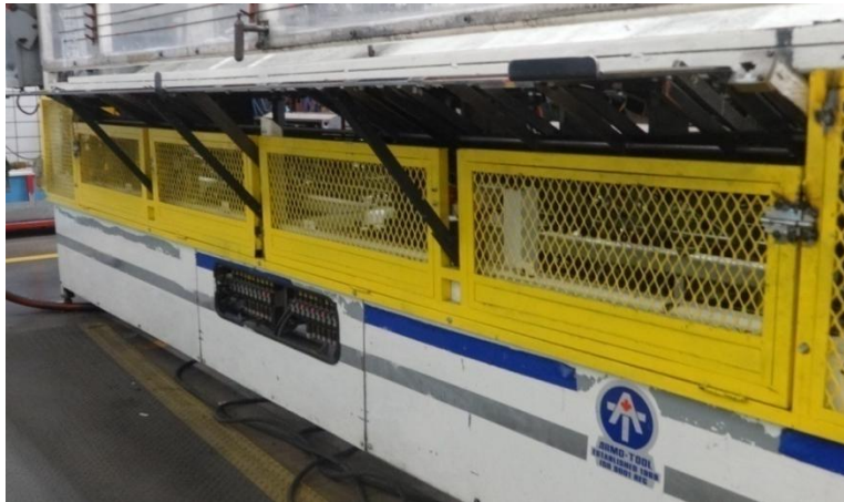
Ilustración 16. Guarda de seguridad en Dobladora
