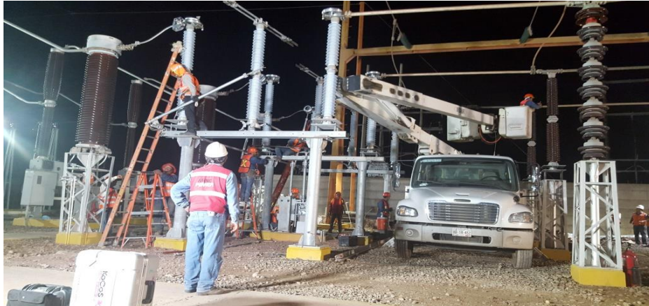
Figura 67. Se procedió a realizar las pruebas con el DUCTER y MEGGER para analizar si los aisladores y contactos estaban en óptimas condiciones para arrancar.
