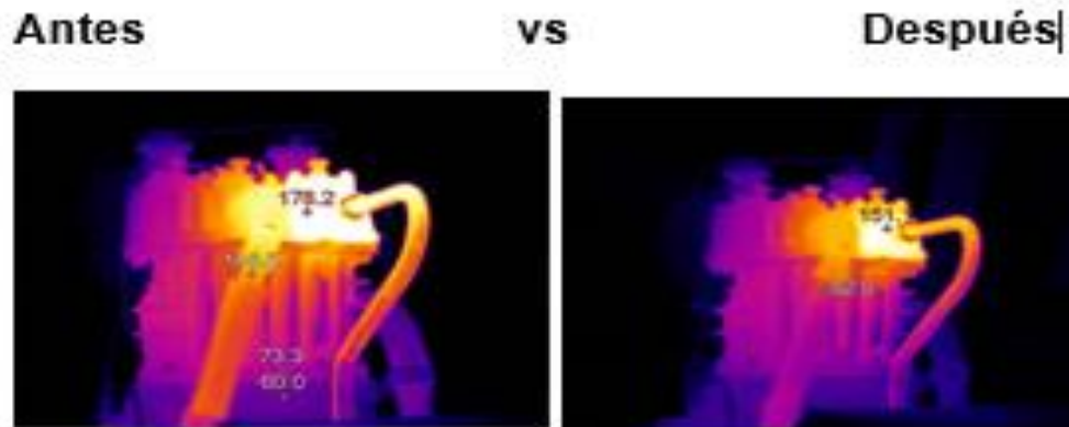
Figura 55. El compresor de la pala 15 al realizar los cambios de manómetros y calibrar las bombas de lubricación del compresor se pudo observar una mejoría y reducción de la temperatura.
