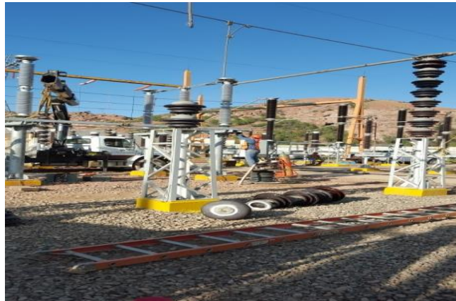
Figura 65. Daño a una columna de aisladores por mal manejo de la empresa contratista.
