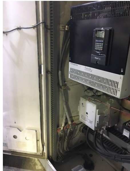
Figura 70. El variador de velocidad marca Allen Bradley ya instalado (controlador motor de rotación)
