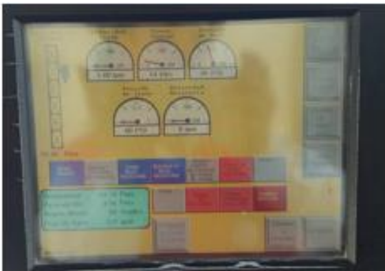
Figura 71. Este es el panel que tenía la perforadora 66 antes de realizar la nueva actualización, se puede está obsoleta y es poco amigable de manejar para el operador.
