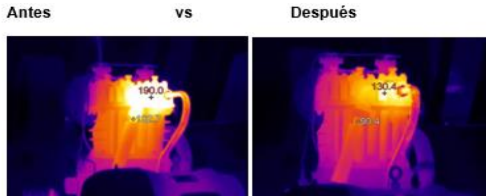
Figura 57. Este es el compresor de la pala 16 al momento de realizar el cambio de manómetro y calibrar los parámetros de las bombas de aceite podemos observar que de una temperatura máxima de 190 grados centígrados bajo a 130.4 grados mejorando así su operación y funcionamiento en el equipo.
