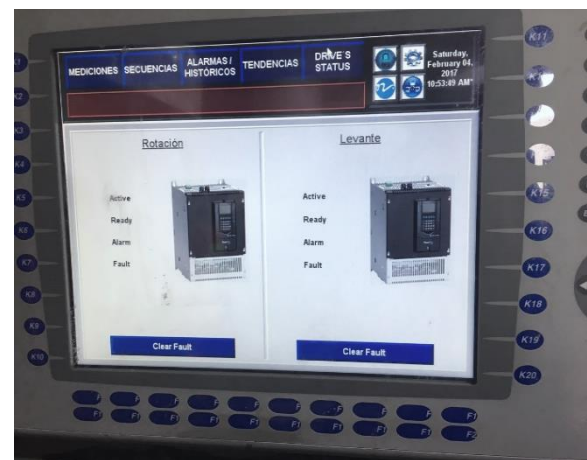
Figura 76. En este display el operador puede presionar la pantalla touch y ver los parámetros de los drives de los controladores de motor de levante o rotación.
