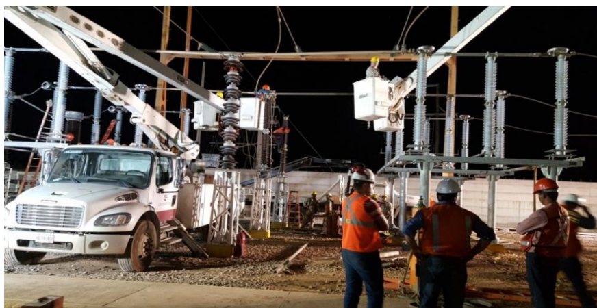
Figura 66. Otras de las causas por el retraso fue el adecuar los buses y los aisladores a la nivelación requerida.
