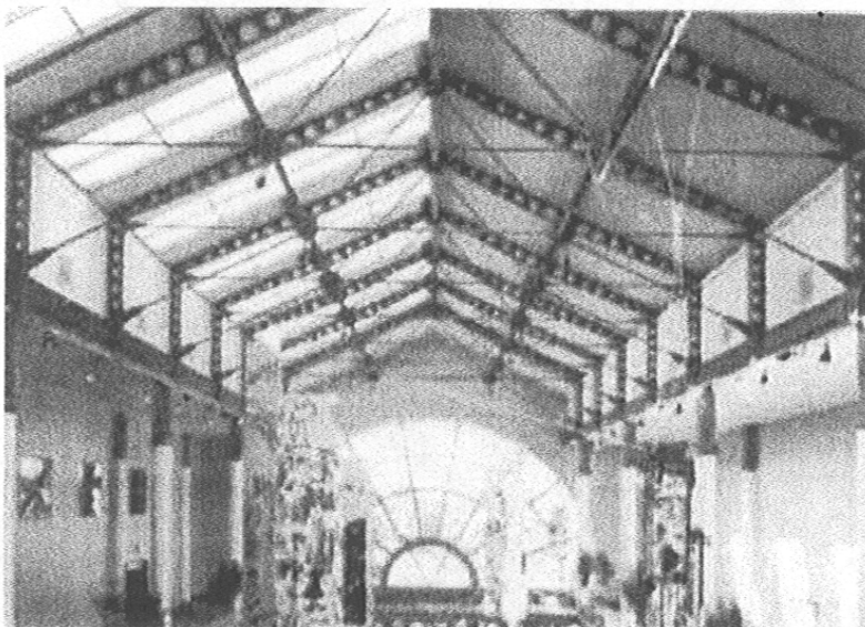
Fig. 2.4 Uso de perfiles agujerados para fines arquitectónicos en estructura principal de la cubierta.
