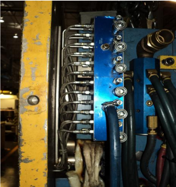
Figura 4.8.a. Sistema de valvulado sin identificación.
