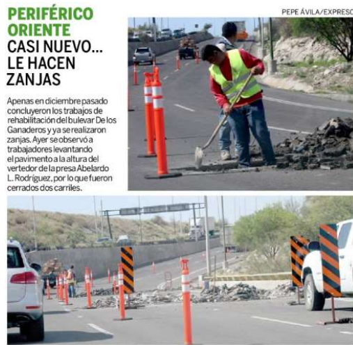
Figura 1.5 Trabajos de reparación en el periférico oriente poco tiempo después de haberlo rehabilitado.
