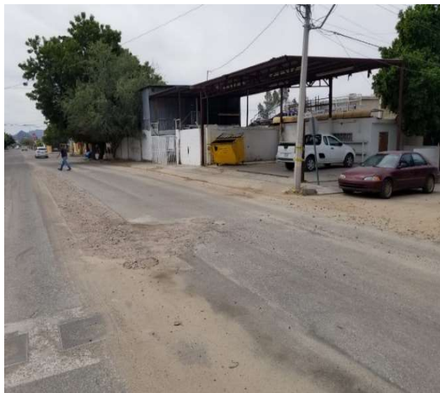
Figura 1.4 Estado de carpeta asfáltica en la calle Israel González posterior a una reparación en la red de drenaje.
