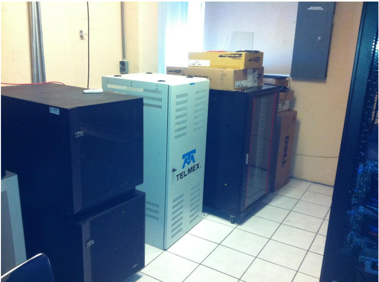
Figura 4.2. Imagen de fondo del área de equipos de cómputo.
