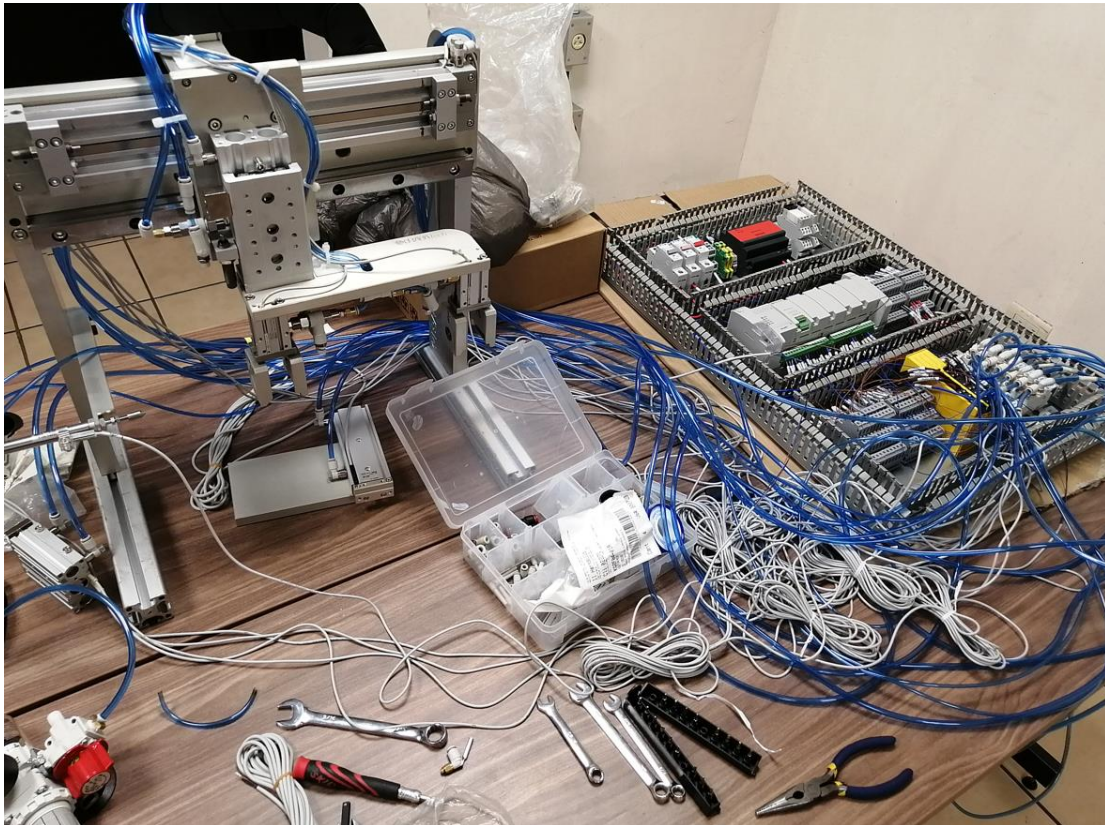
Imagen 8.3.1 Gabinete de control conectado a subensambles mecánicos. {1}
