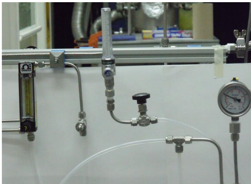
Figura 46) Conexiones de oxígeno, aire seco y medidor de presión.
