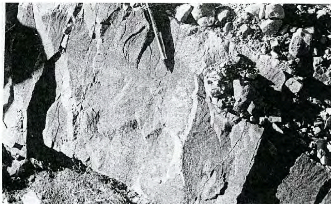
Figura 47.- Estrato mediano de arenisca de la Formación Cintura, unidad C, sección D-D'.
