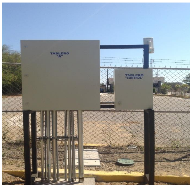
Figura 4.16 Foto Tablero A
