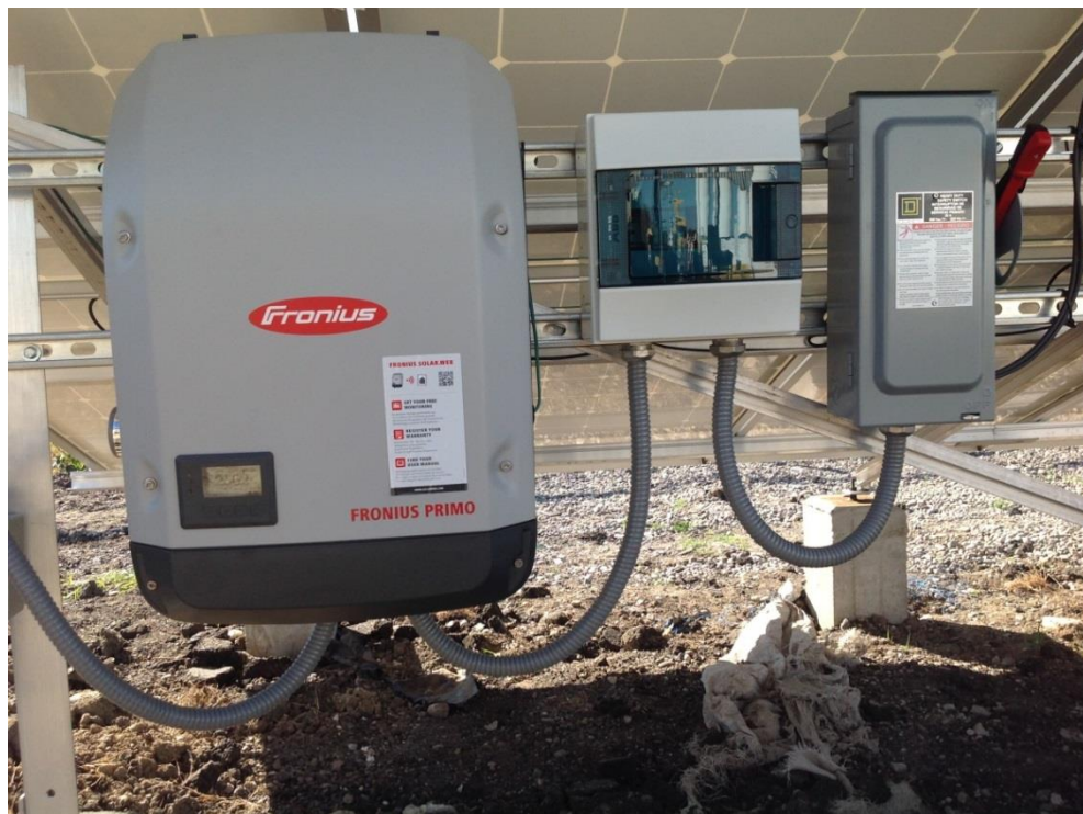
Figura 4.17 Foto Inversor con su sistema de seguridad
