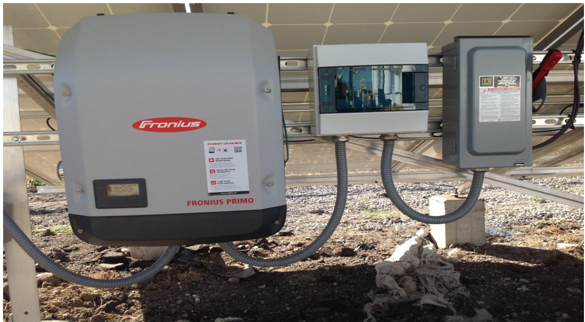
Figura 4.25 Foto Vista inferior de un arreglo con inversor general (Mazatlán)
