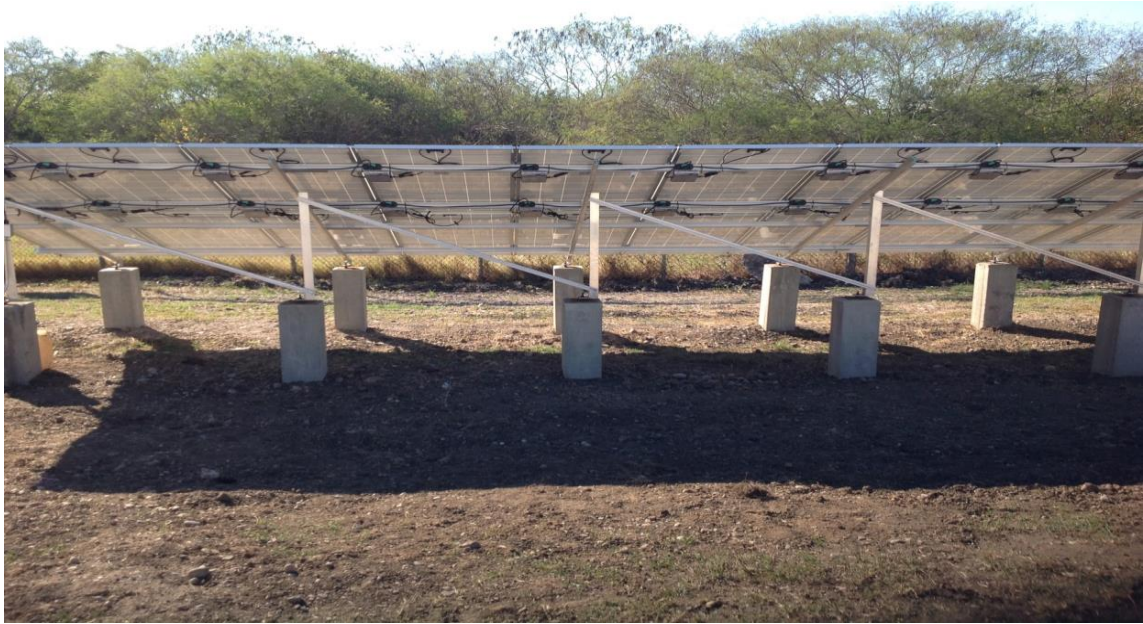
Figura 4.24 Foto Vista inferior de un arreglo con micro inversores (Mazatlán)
