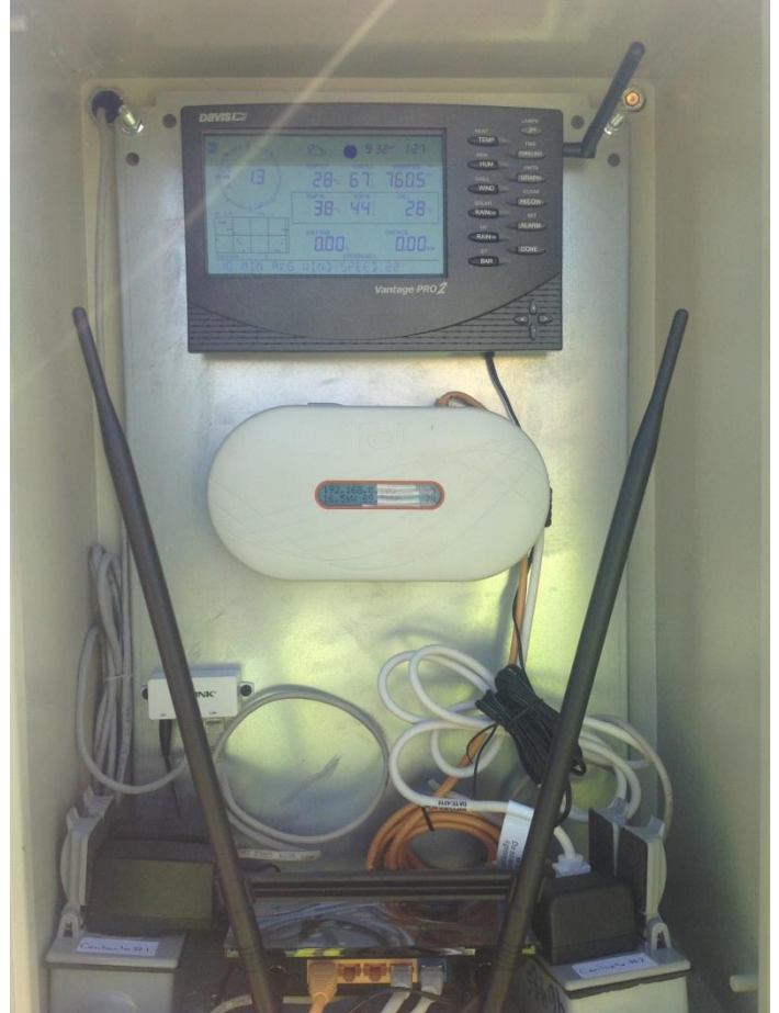
Figura 4.21 Foto del tablero de control
