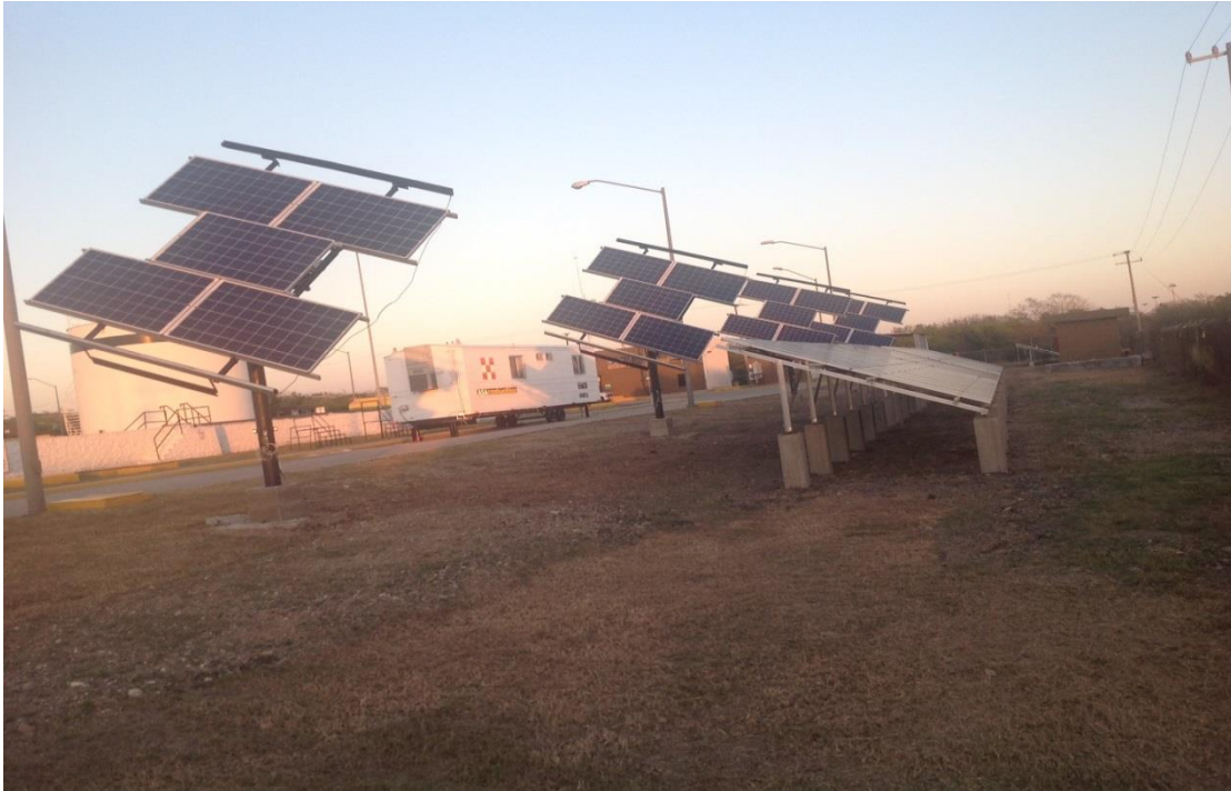
Figura 4.22 Foto Vista lateral del Sistema Fotovoltaico Mazatlán
