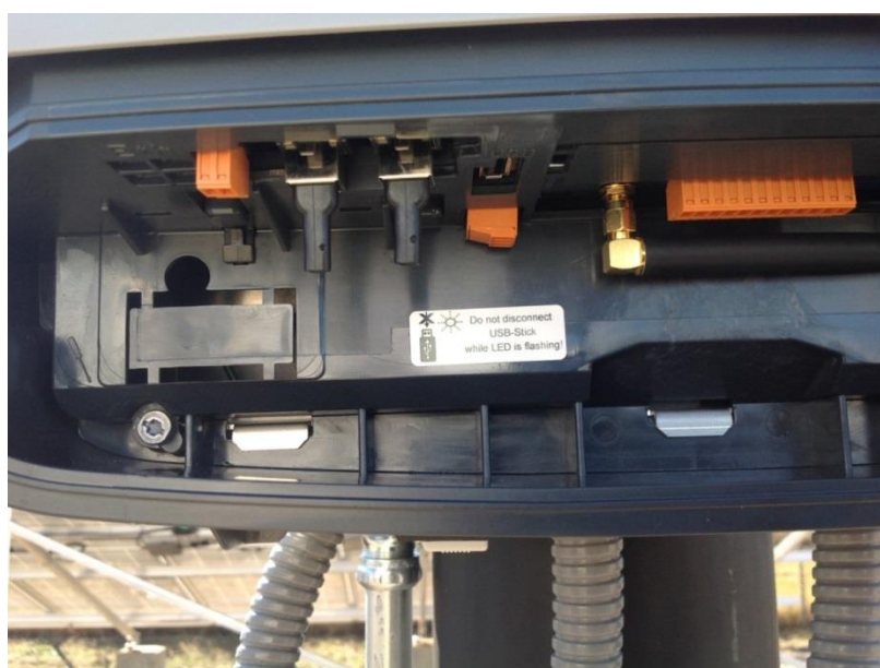
Figura 5.2 Foto tarjeta de red inversor general primo
