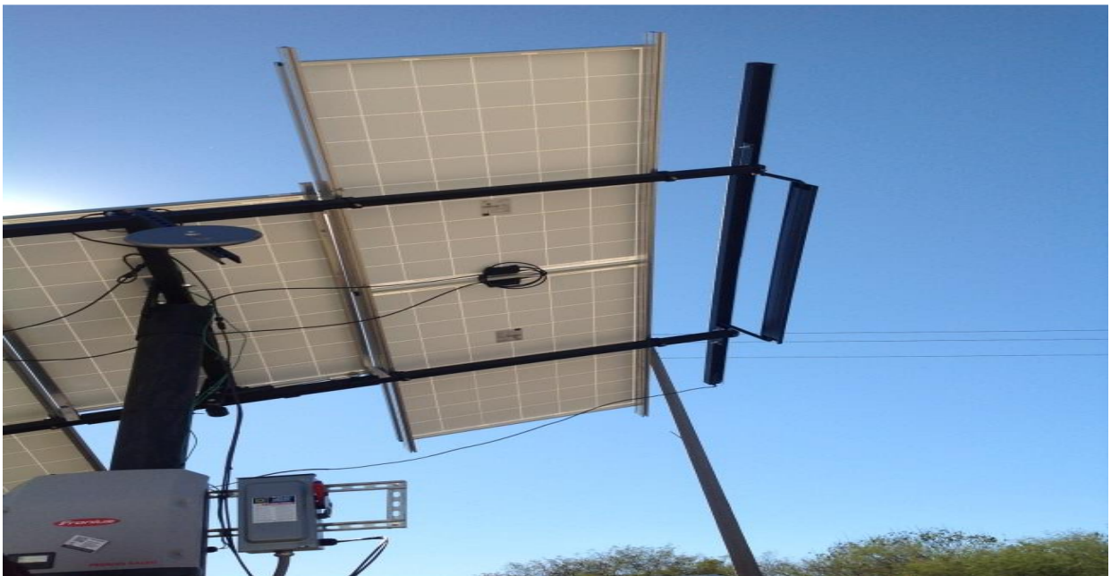
Figura 4.27 Foto Vista inferior de un seguidor con inversor general (Mazatlán)
