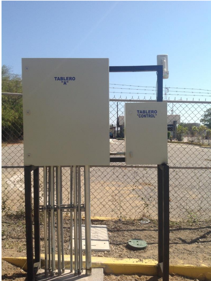
Figura 4.20 Foto de los tableros de control
