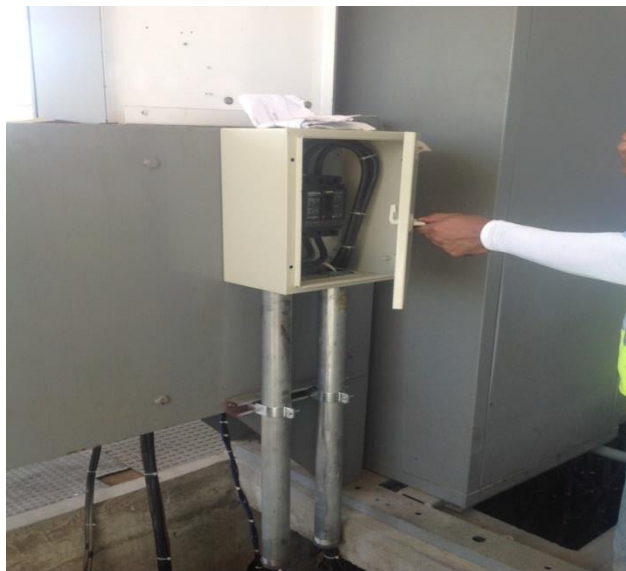
Figura 4.19 Foto del interruptor principal
