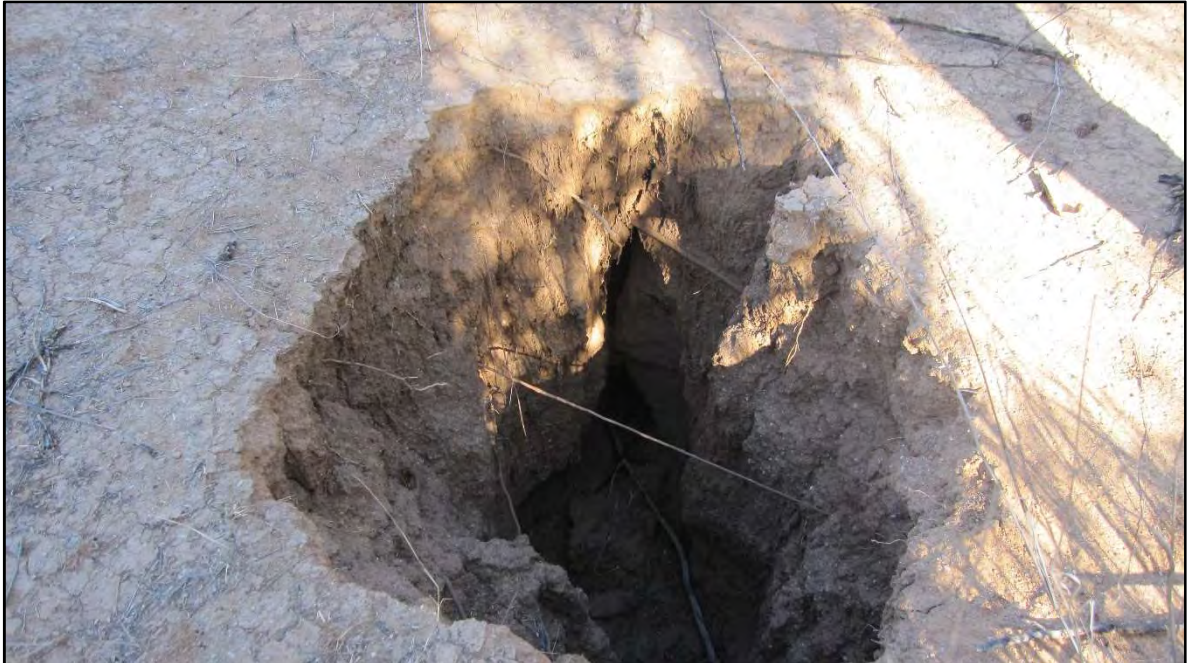
Fotografía 4.- Una evidencia muy importante que se encontró fueron una especie de hoyos o hundimientos que van paralelos a las grietas que cortan el drenaje.
