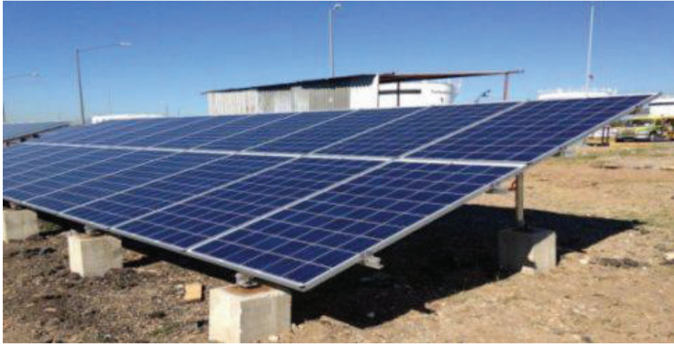
Figura 3.9 Celdas fotovoltaicas policristalinas (250 watts producidos por cada celda; Fotografía: Impulsor Eléctrico S.A de C.V) [2].
