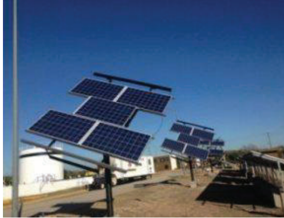
Figura 3.11 Seguidores Solares ( Fotografía: Impulsor Eléctrico S.A de C.V ) [2].
