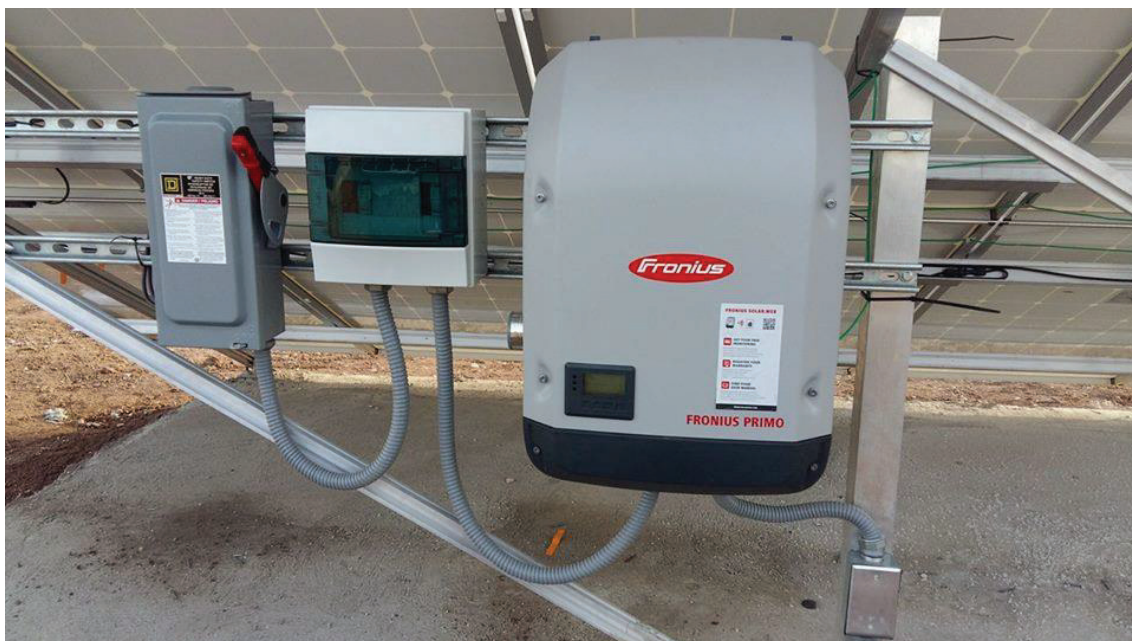
Figura 3.2 Inversor General Primo. (Fotografía: Luis Donald Rodríguez Chavarín)
