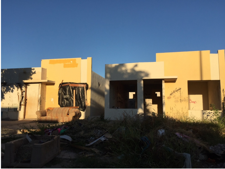
Fotografía 3. Vivienda abandonada, Villa Verde 2017. Fuente propia
