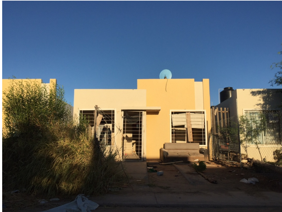
Fotografía 5. Vivienda abandonada, Villa Verde 2017. Fuente propia
