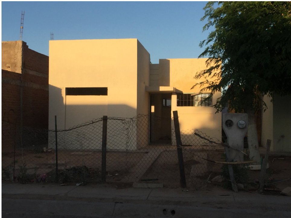
Vivienda en condiciones de abandono, ocupada en la 4ta etapa del Fracc. Villa Verde
