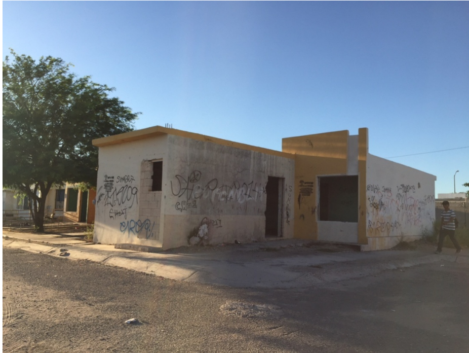
Fotografía 2. Vivienda abandonada, Villa Verde 2017. Fuente propia
