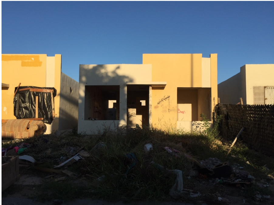
Fotografía 9. Vivienda abandonada, Villa Verde 2017. Fuente propia
