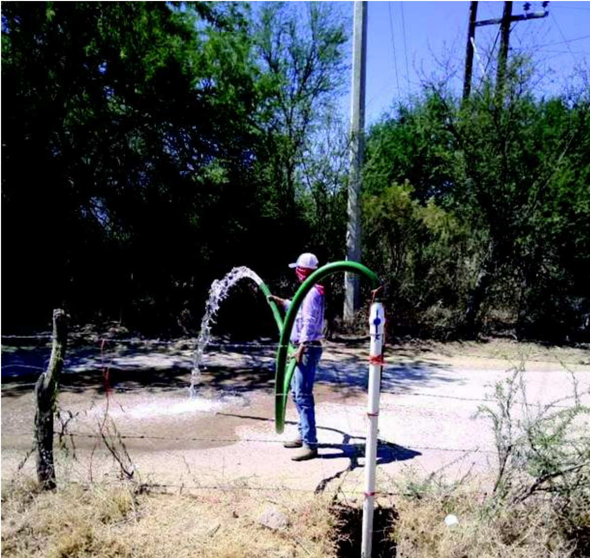
Fotografía 8. Toma de agua tipo garza
