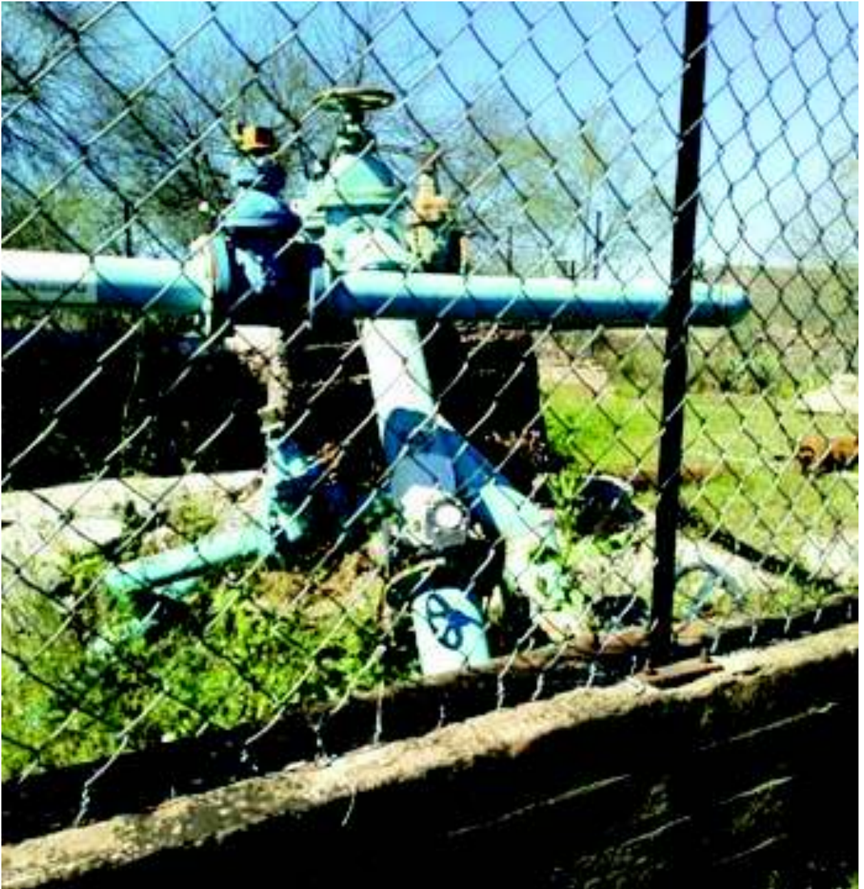
Fotografía 5. Pozo de agua
