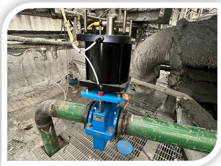
Figura. 25 Válvula tipo “PID” para Agua al Molino.
