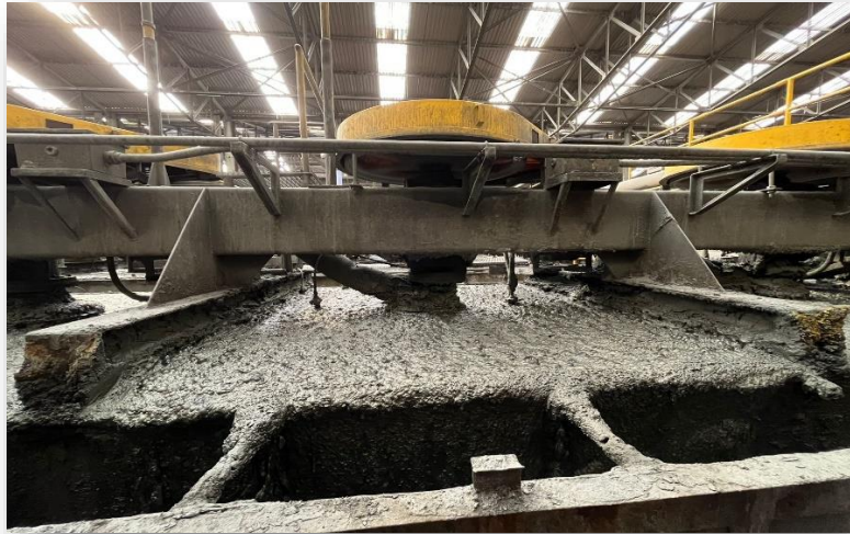
Figura. 1 Celda de flotación
