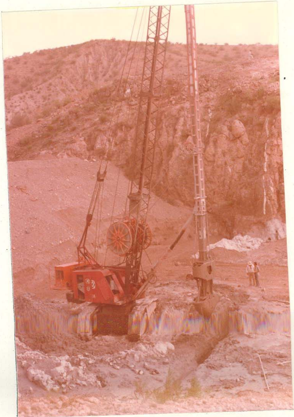
F. 19.- Extracción de los materiales de acarreo para la construcción de la Pantalla Flexible.
