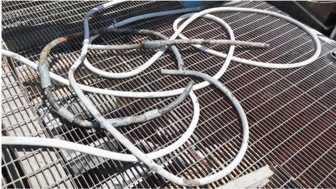
Figura 23. Mangueras sin usar en las celdas.
