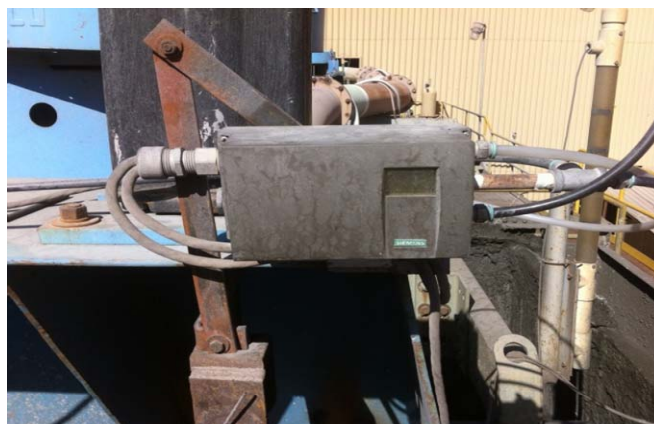
Figura 13. Posicionador de control automático para las celdas WEMCO.
