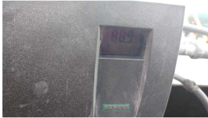
Figura 14. Funcionamiento del posicionador, en este caso indica la apertura de un 88.9 % de la salida.
