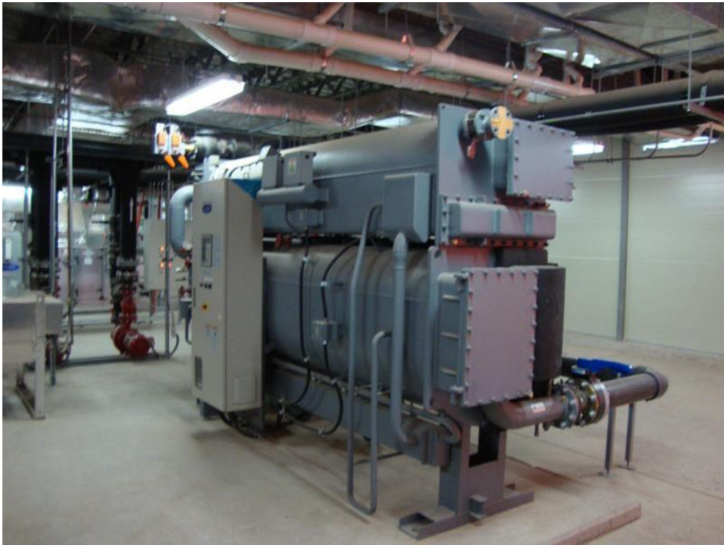
Figura III.7 Enfriador CARRIER-SANYO instalado en planta.
