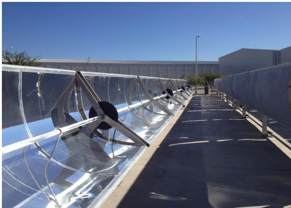
Figuras II.20 y II.21 Vista parcial del campo solar montado a suelo.
